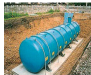
【耐震性貯水槽】
